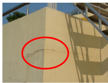
4-2-29：樓板龜裂滲水
