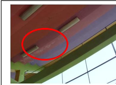
4-2-28：樓板龜裂滲水
