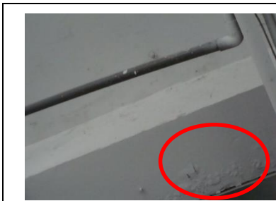
4-2-34：樓板龜裂滲水
