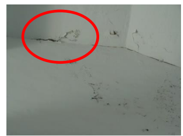
4-2-33：牆壁龜裂滲水
