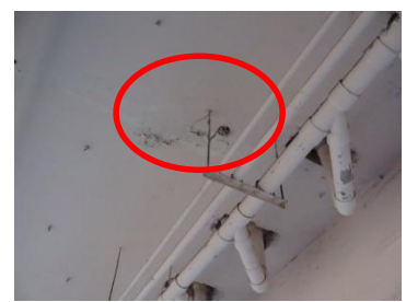
4-2-36：樓板龜裂滲水
