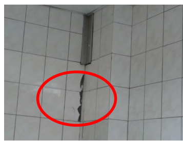
4-2-32：牆壁龜裂滲水
