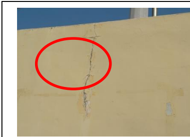
4-2-31：牆壁龜裂滲水
