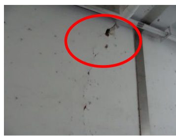
4-2-35：牆壁龜裂滲水
