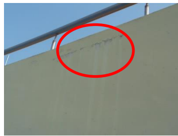
4-2-26：樓板龜裂滲水
