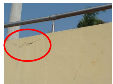
4-2-30：牆壁龜裂滲水
