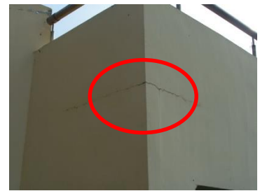
4-2-27：牆壁龜裂滲水
