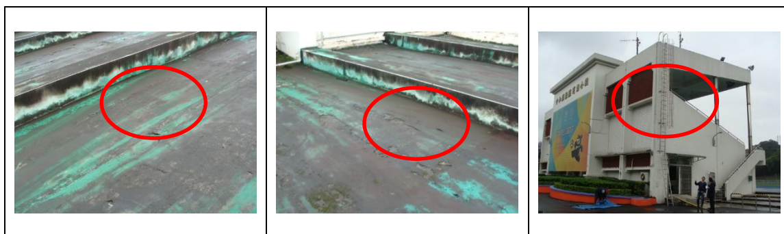
圖 4-2-16：屋頂防水層損壞
