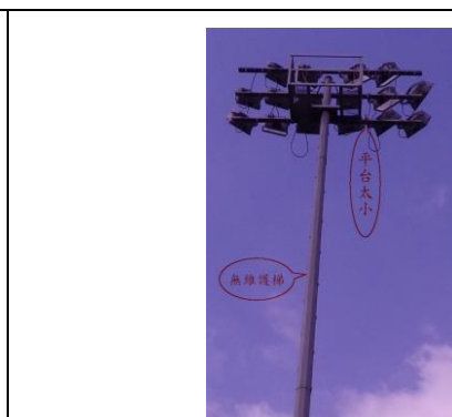
圖 4-3-4：舊柱無維護梯及維修平臺寬度不足舊柱
