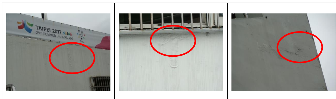
圖 4-2-4：外牆面漆損壞
