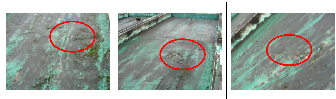
圖 4-2-13：屋頂防水層損壞
