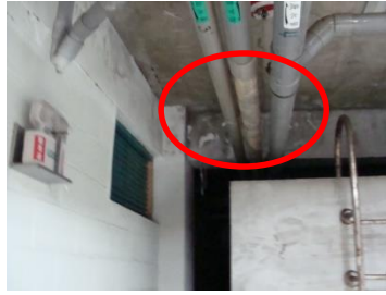
圖 4-2-26：地下室牆龜裂
