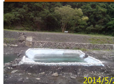
沉砂池控制濁度
