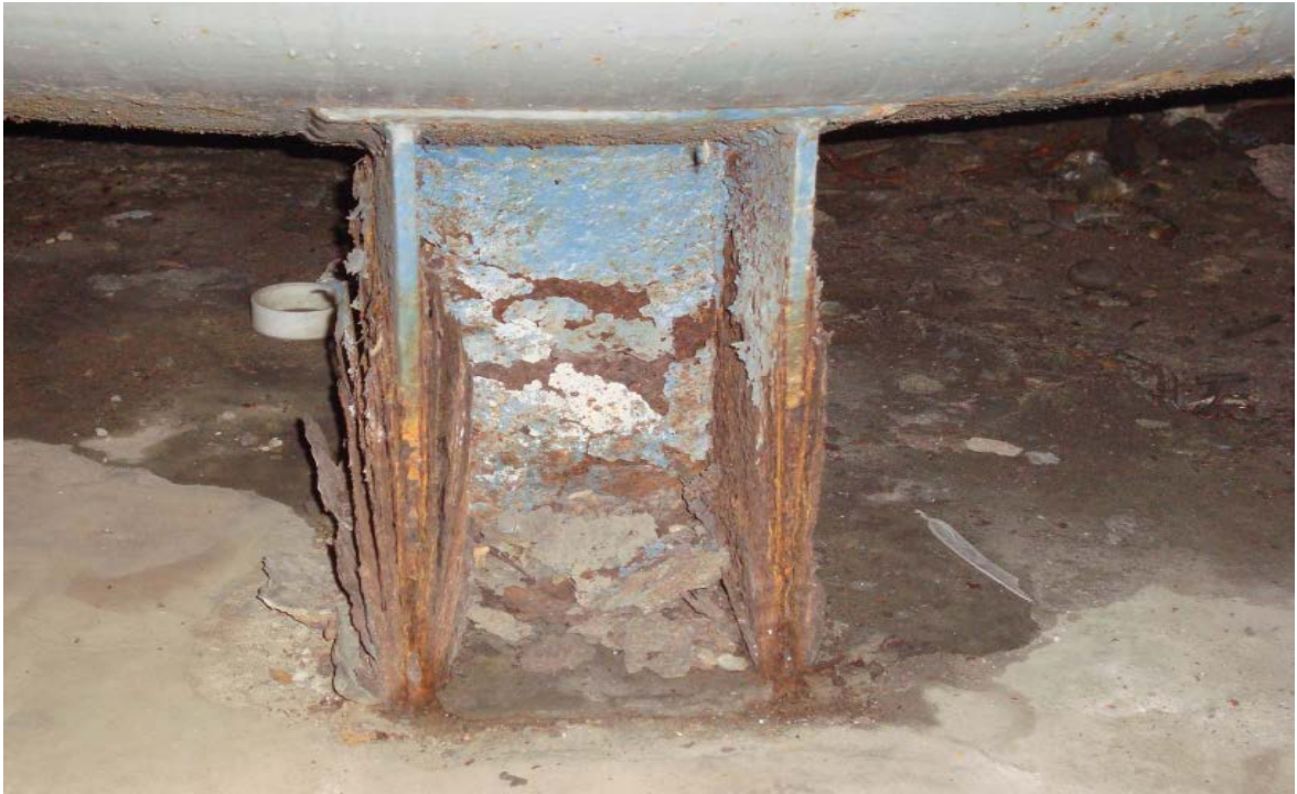
機房設備應定期維護，尤應注重管線、機具之防銹處理及上漆。
