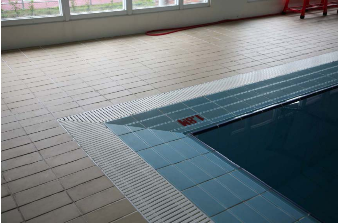
游泳池畔應標示水深，池岸施工應平整，維持良好之溢水功能。
