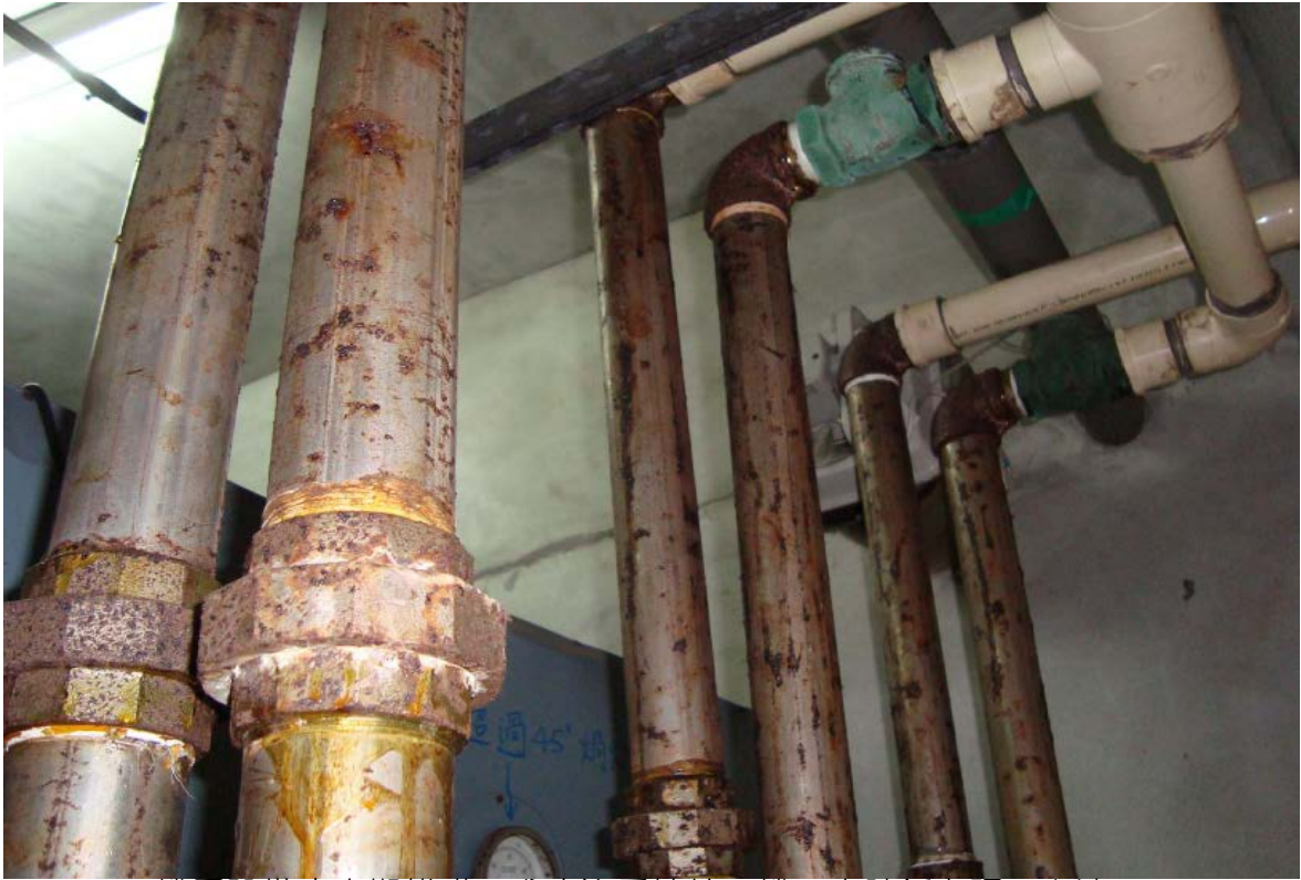
機房設備應定期維護，尤應注重管線、機具之防銹處理及上漆。
