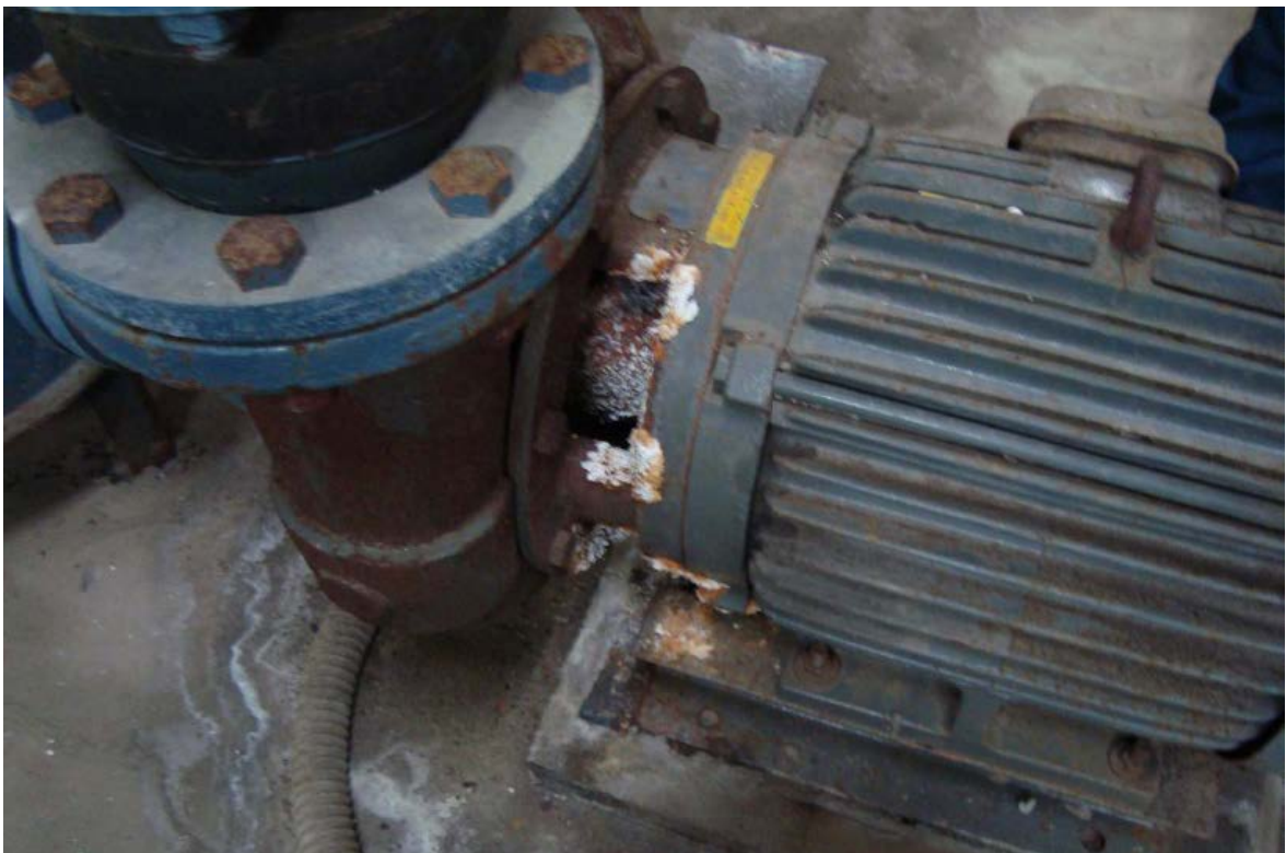
機房設備應定期維護，尤應注重管線、機具之防銹處理及上漆。
