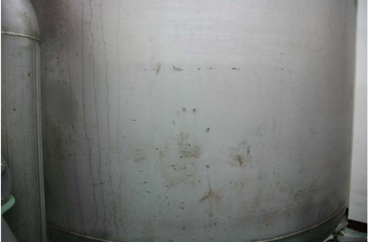
過濾桶如採用不銹鋼設計應確保其品質，以避免銹蝕（本案設置未滿 2 年）。
