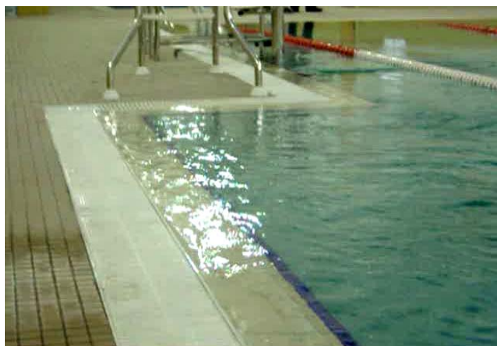
圖 12 池水不斷溢流至溢水溝
